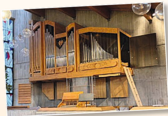
Fotos Seite 31 von oben nach unten: alter Schleifenzugmagnet Typ 12V // das verbaute 24 V Schaltnetzteil zur Versorgung der Magnete // die alten Schleifenzugmagnete, mit nicht mehr zulässiger Verdrahtung.
